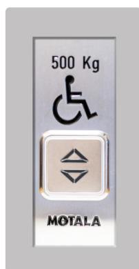
Anropsknappar i väggen
